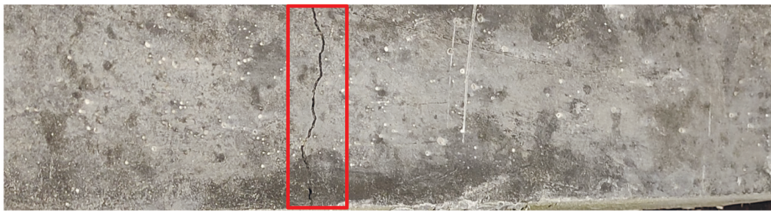
Рис. 5. Образец образца из бетона с выделенным участком, содержащим трещину.
