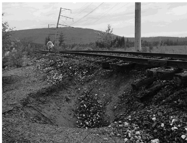
Рис. 10. Образование суффозионной воронки глубиной 1.5 м на железнодорожной ветке Новая Чара – Чина (3-й километр дороги) (фото А. Кулакова).
