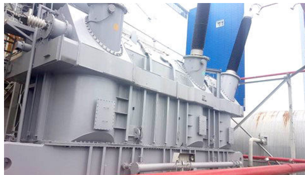
Рис. 5. Внешний вид трансформатора со стороны ВН
