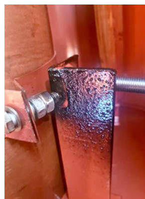
Рис. 4. Вероятное место дефекта (т. 24, 25, 26)
