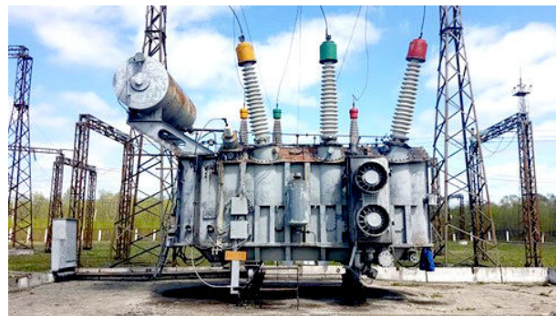
Рис. 1. Внешний вид автотрансформатора АТДЦТН-63000/220
