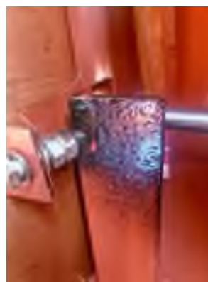
Рис. 4. Вероятное место дефекта (Т. 24, 25, 26)
