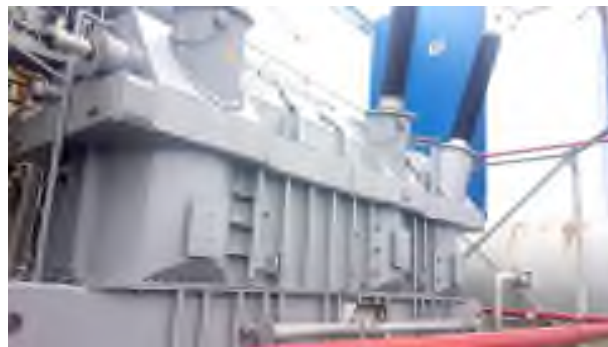
Рис. 5. Внешний вид трансформатора со стороны ВН
