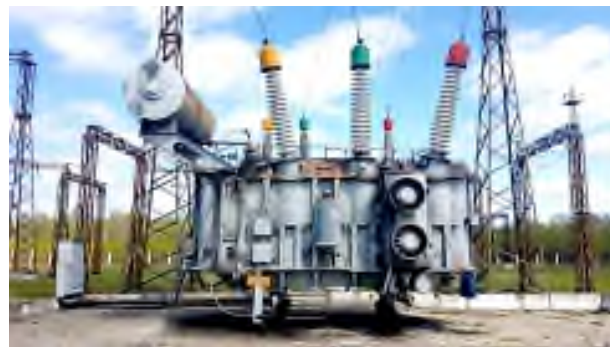
Рис. 1. Внешний вид автотрансформатора АТДЦТН-63000/220
