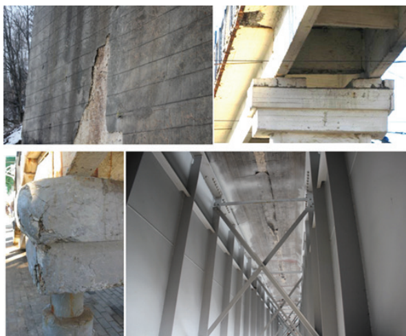
Рис. 1. Конструкции мостов с высокой степенью износа
