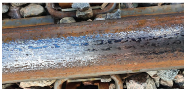
Рис. 11. Пятна металла, перенесенного на рельс с башмаков
