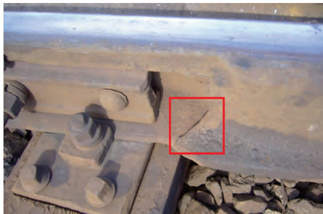
Рис. 1. Трещина в литой части сердечника крестовины типа Р50
