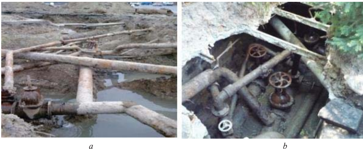
Fig. 3. Water supply network management units before reconstruction: a) network; b) chamber Рис. 3. Узел управления сетью водоснабжения до реконструкции: а) сеть; б) камера
