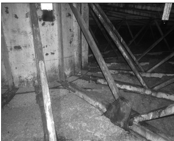
Рис. 3. Поверхностная коррозия элементов стропильных конструкций покрытия
