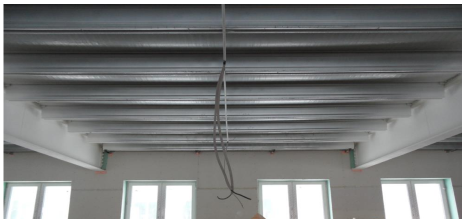
Рис. 1. Начальные прогибы профлиста при бетонировании Fig. 1. Initial deflections of the corrugated sheet after concreting
